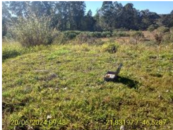
Foto 36 Registro da Instalação do Equipamento – VB-03
